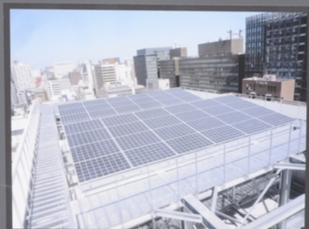
当ビル屋上に設置された太陽光発電パネル
